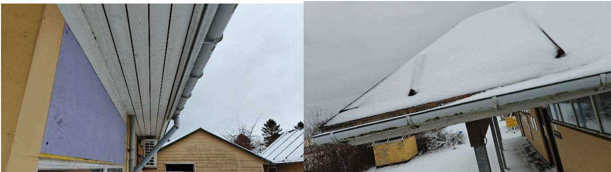
Figur 16: Tagudhæng (venstre) fremstår med smalle mellemrum mellem brædder. Taget oppefra (højre) er tæt.
