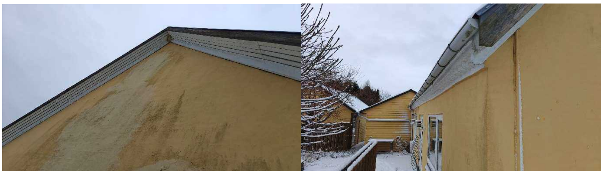
Figur 12: Tagudhæng på gavl (venstre) fremstår med smalle mellemrum. Gesims (højre) på siderne er tætte.
